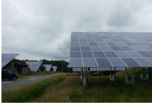
Gambar 8.2 Fasilitas Pembangkit Listrik Tenaga Surya di Kota Saerbeck, Jerman ( Sumber: Sagala, 2014 )
